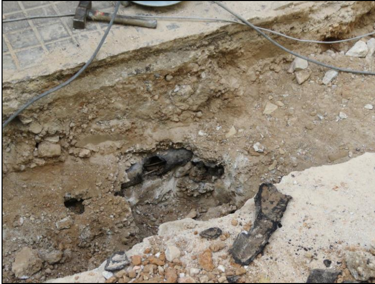
Vista del tub que envolta els cables d'electricitat
